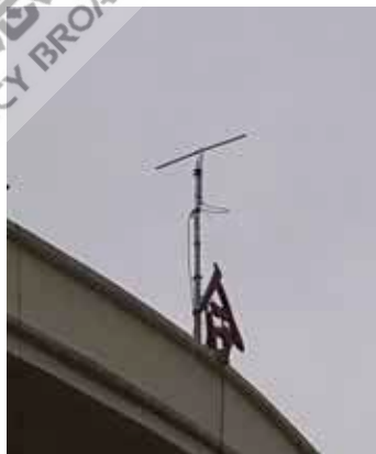
图10 综合楼顶架设的调频天线
